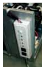
Detección de averías por LEDS
